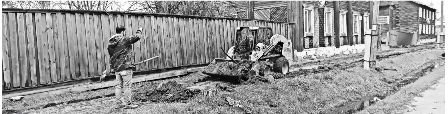
Отремонтированную пешеходную дорожку по ул. Худзинского скоро смогут оценить не только енисейцы, но и гости нашего города
