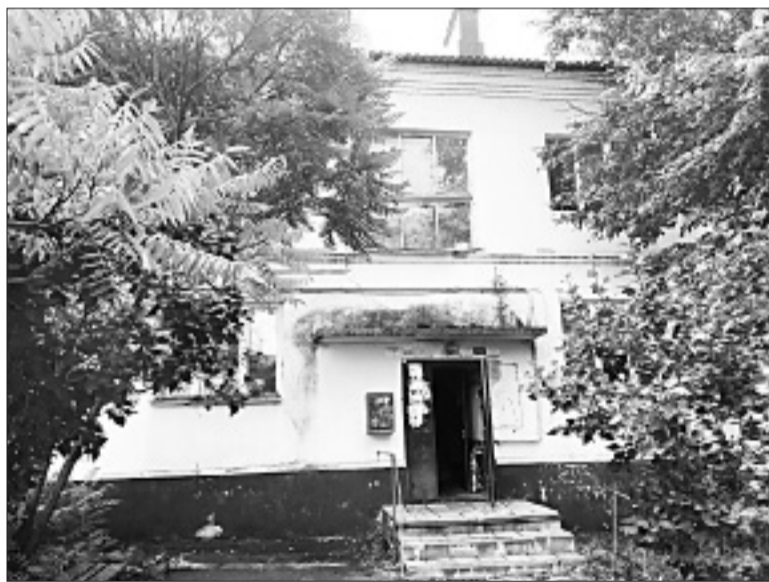
■ Даже проведённый некогда ремонт не повлиял на степень ветхости этого дома. / ФОТО: РЕДАКЦИЯ
