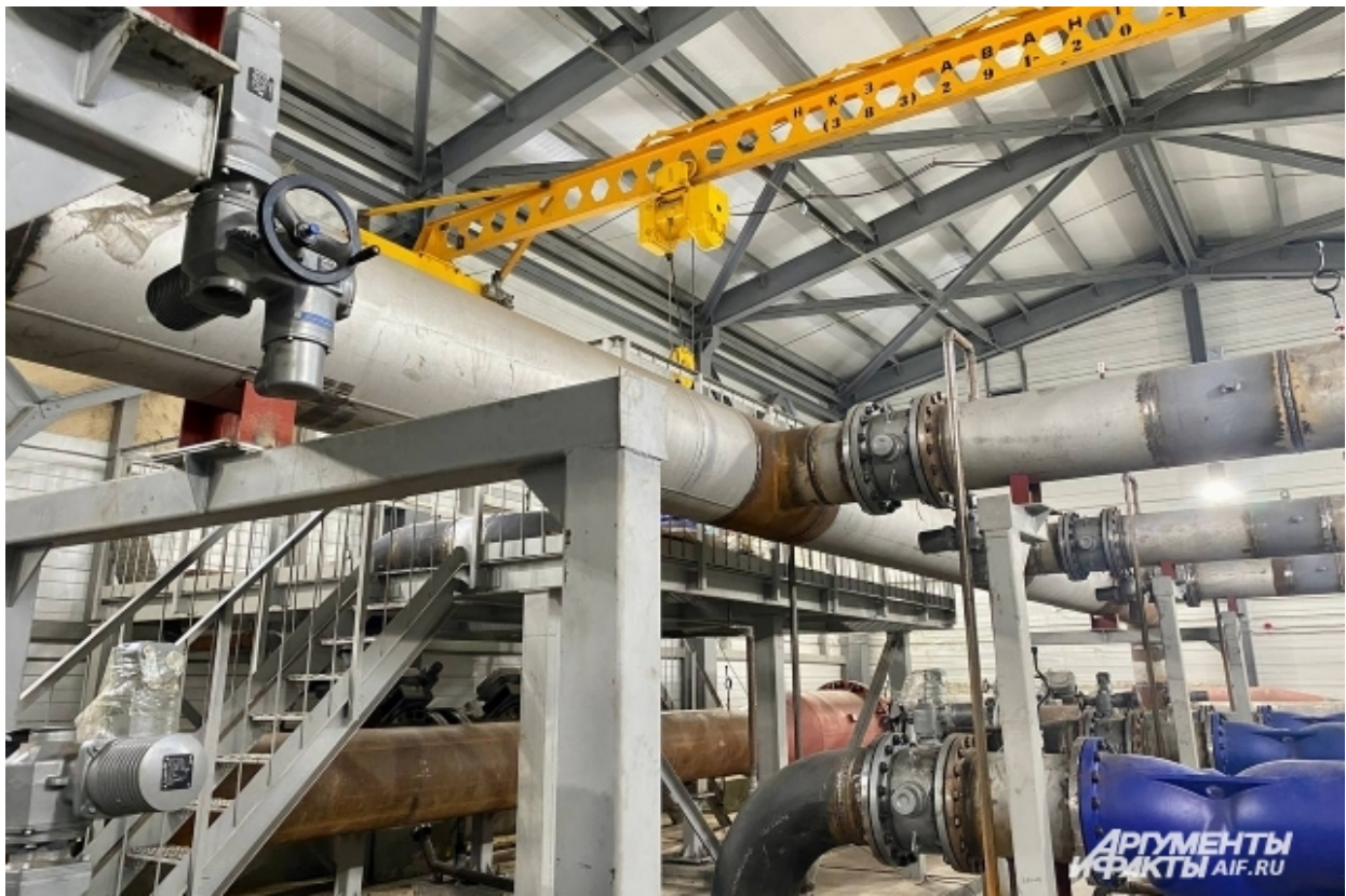
Для обеспечения микрорайона теплом уже готова полностью автоматизированная повысительная насосная станция. Фото: АиФ
